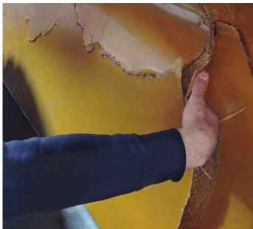
Auch große Schäden am Güllefass bedeuten nicht das Ende des Behälters.
